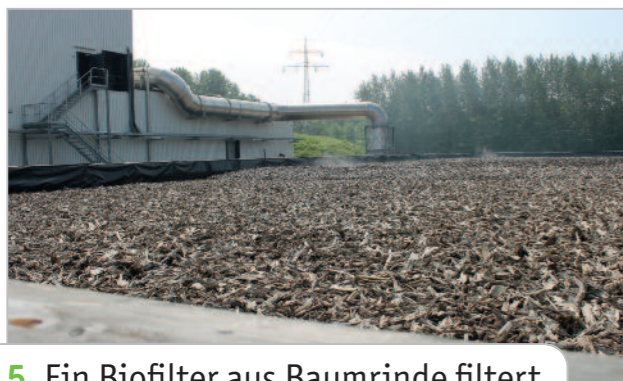
5. Ein Biofilter aus Baumrinde filtert die Abluft aus den Rottetunneln.
